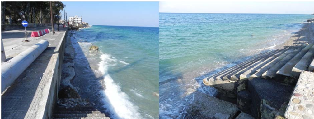
Εικόνα 4. Θέση κατά μήκος του παραλιακού μετώπου Μελισσίου, όπου η έντονα διαβρωτική δράση των κυμάτων έχει προκαλέσει σοβαρές ζημιές ακόμη και στο προστατευτικό τοιχίο κατά μήκος του παραλιακού δρόμου (αριστερά). Δεξιά φαίνονται καταστροφές σε κτίσματα κατά μήκος της παραλίας του Καμαρίου.
